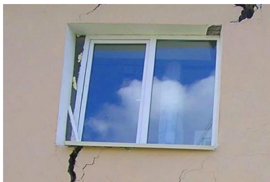
Рис. 7 – Трещина над и под оконным проёмом
