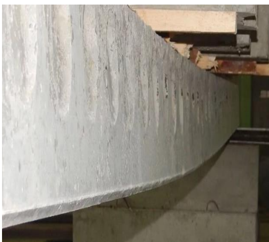
Рис. 5 – Прогиб железобетонных элементов
