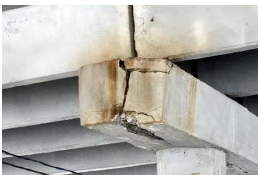
Рис. 8 – Наличие растрескиваний в опоре плиты
