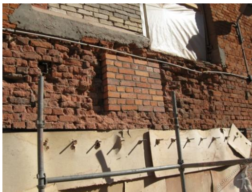
Рис. 1 – Выпадение раствора по швам наружных стен
