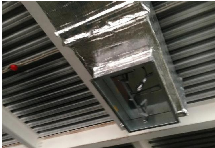
Рис. 2 – Клапан дымоудаления в подшивном потолке
