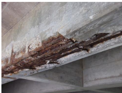
Рис. 4 – Коррозия закладных деталей
