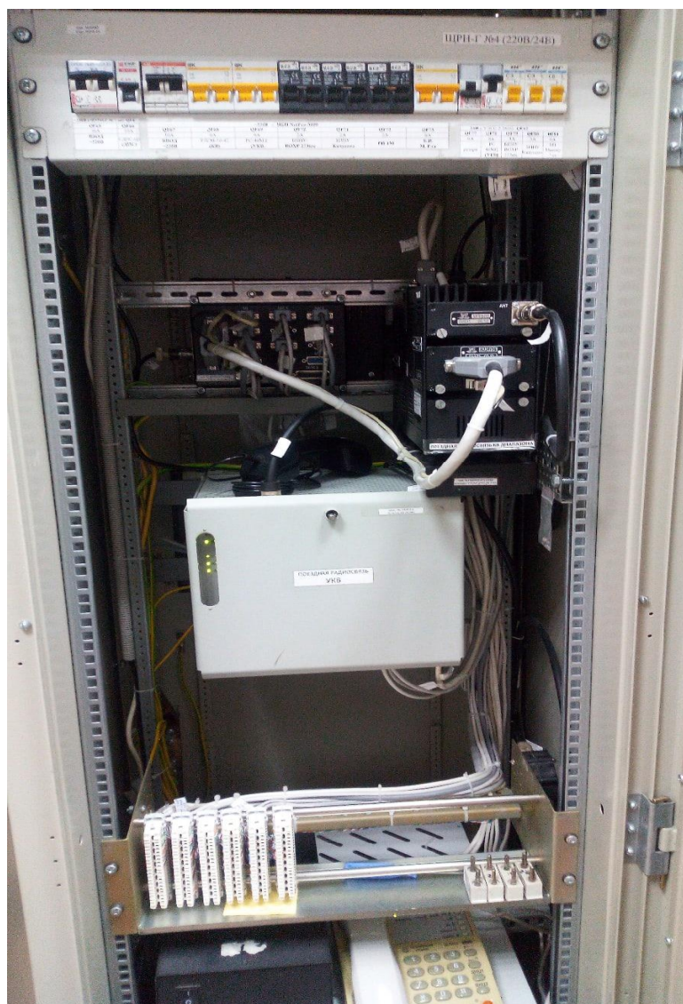
Рис. 2 – Оборудование на железнодорожной станции после модернизации по технологии микропроцессорной централизации
